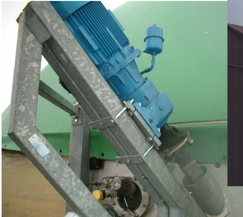
Gegen Schwingungen gesichertes Rührwerk
