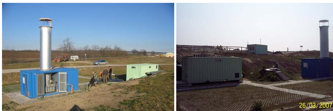
Bild 10: Maschinentechnische Anlage im Frühjahr 2007
