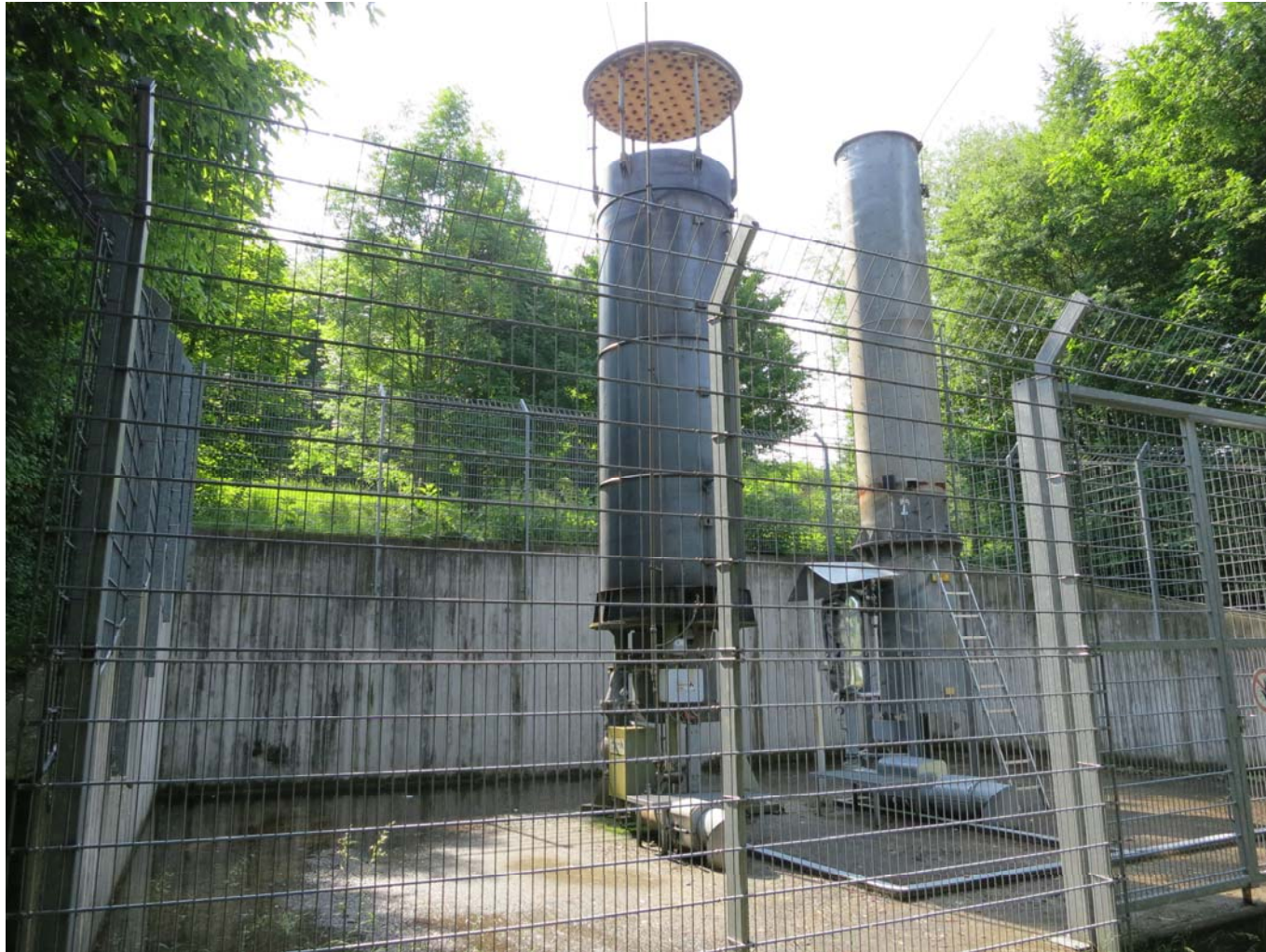
Abb.2: alte Fackelanlage mit 1250 und 350 m 3 /h Fackeln
