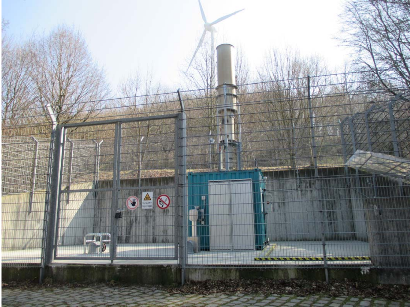
Abb.3: neue Fackelanlage CHC 50
