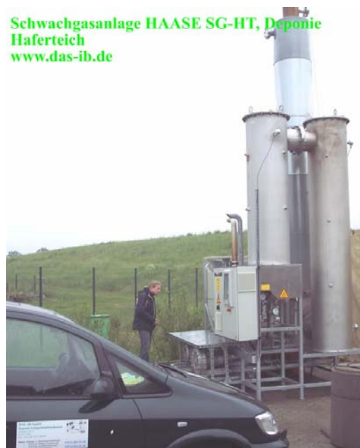
Abbildung 2: die HAASE SG-HT-Anlage auf der Deponie Haferteich
