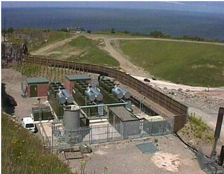
Bild 4: Deponiegas – JES – Containeranlagen der Clarke Energy Ltd. in Wales
