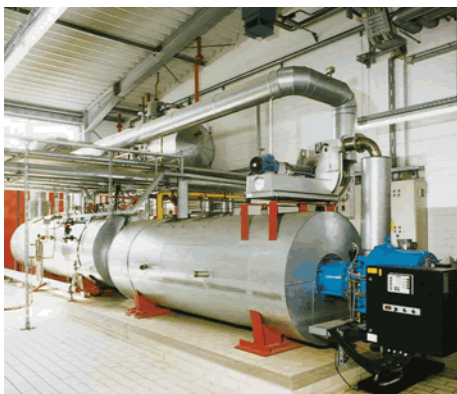
Bild 6: Dampfkessel und Deponiegasbrenner, 10 MW th , 20 bar
